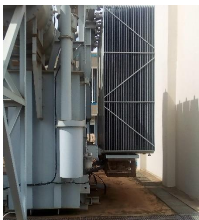
変圧器の接地部分
