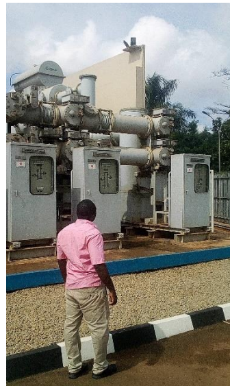
屋外用 132kV ガス絶縁開閉装置
